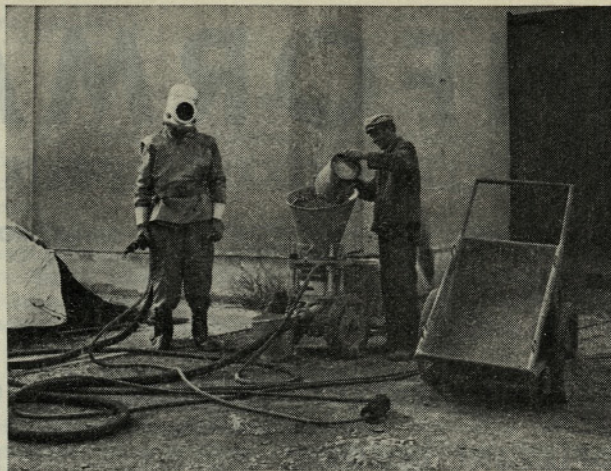
Peskanje betonske plošče
